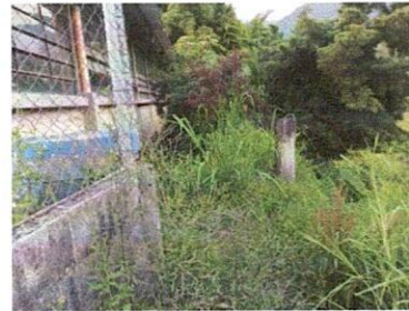
Foto 2: VISTA DE MURO PERIMETRAL EN RIESGO
