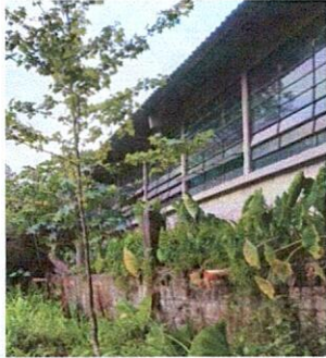
Foto1: DETERIORO DE MURO DE CONTENCIÓN
